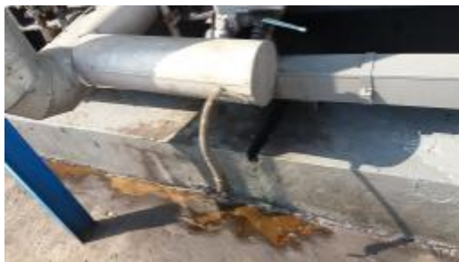
3.5 现场漏油情况
